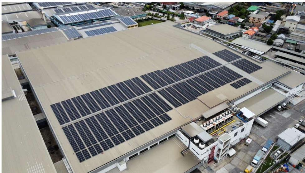
ระบบผลิตไฟฟ้าพลังงานแสงอาทิตย์ภายในศูนย์กระจายสินค้า
